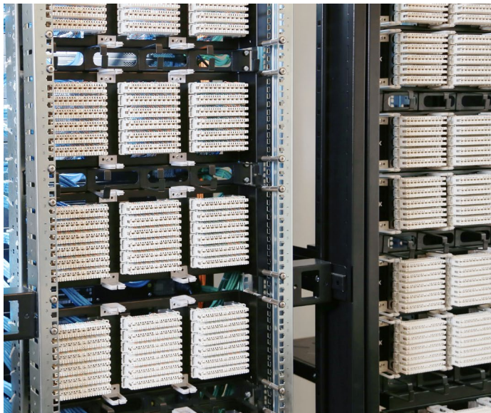
Обратная сторона серверного шкафа с планками для подключения аналоговых линий к устройствам Symway.
